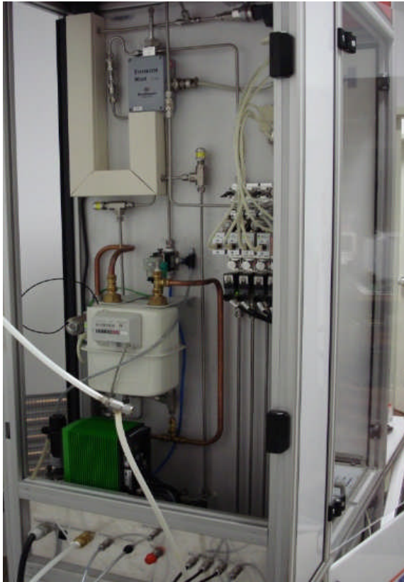
Vista traseira dos controladores
